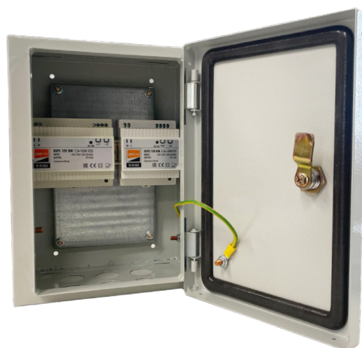
Пример установки блоков питания BSPS DIN на DIN-рейку в электрическом шкафу
